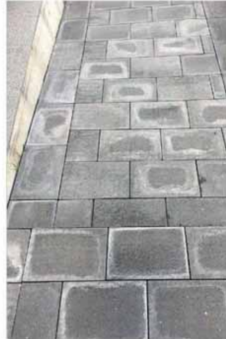
Außenanlage mit Kalkausblühungen.
