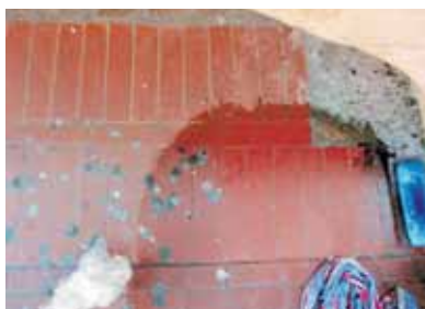
Der Klinkerboden leidet unter den Kaugummiresten.
