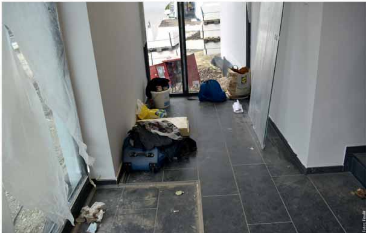
^ Ein typisches Bild auf vielen Baustellen: Die Bodenbeläge haben unter den Bauarbeiten gelitten, die keramischen Fliesen sind verschmutzt und unansehnlich.
