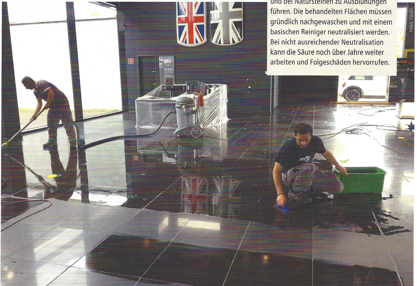
Treten nach der Verlegung Zementschleier auf dem Fliesenbelag auf, ist eine Profibehandlung mit Spezialreinigern notwendig.
