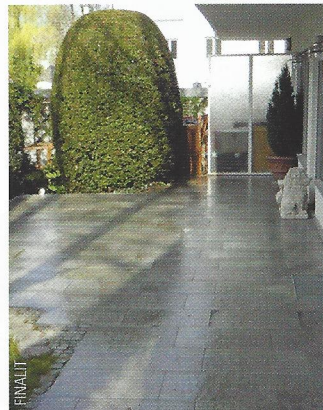
Vor der Reinigung ist die Terrasse durch Witterungseinflüsse völlig verschmutzt.
